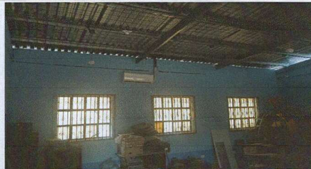
Foto 6: INSTALACION ELECTRICA DE AIRE ACONDICIONADO YA EXISTENTE, INCLUYE CAJA Y FILPON
